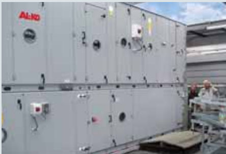
Снимок снаружи центральной установки AL-KO из проходной центральной венткамеры
